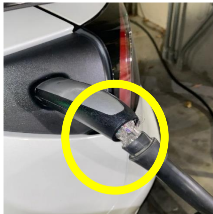
Ilustración 5 Cable de carga de VE con desperfecto.
