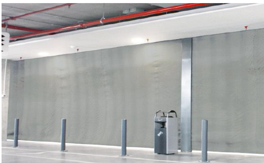
Ilustración 11. Cortinas cortafuego de aislamiento del área de aparcamiento con VE
